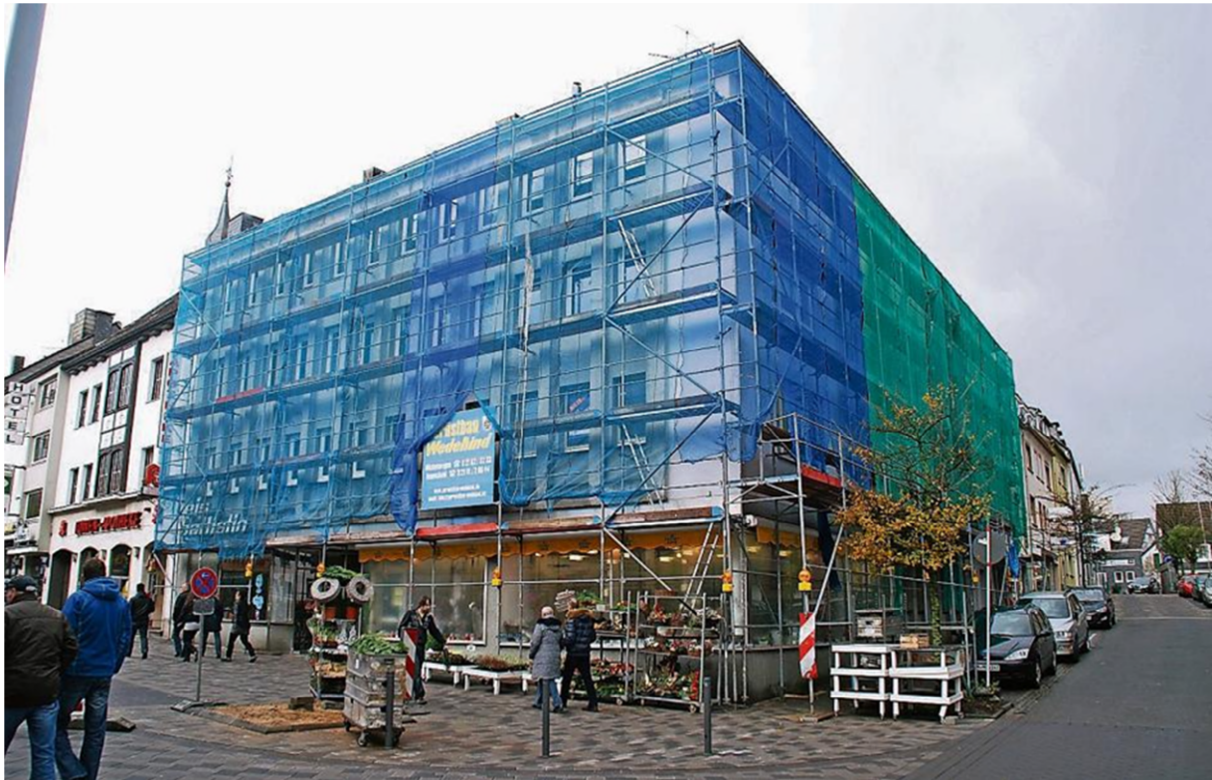
Gehört zwar noch nicht zum Programm, ist aber auch eine wichtige Maßnahme, um die Innenstadt attraktiv zu machen: die Fassadensanierung an der Ecke Kaiserstraße/Bischof-Bornewasser-Straße. Foto:wos
